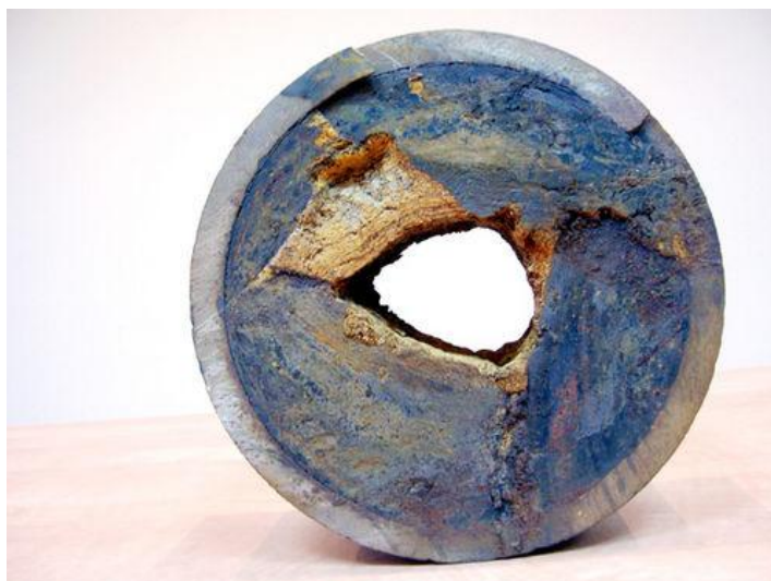
Ryc. 1. Przykład przewężenia przewodu wodociągowego uniemożliwiającej inspekcję (źródło własne)
